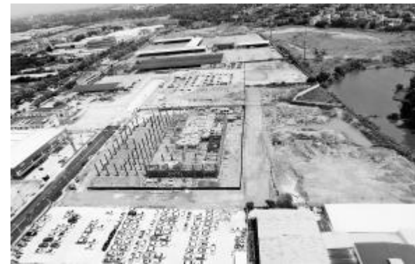
创兴大道2个施工工地裸土砂石未完全覆盖。
